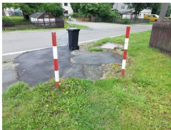
Restauration (Schäden an Pfosten; Marienberg OT Satzung, Satzunger Hauptstraße)
