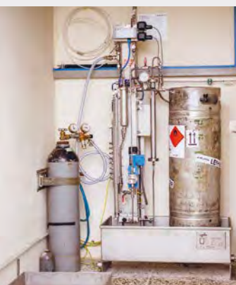
Die Odorieranlage gibt dem Gas seinen charakteristischen Geruch.
